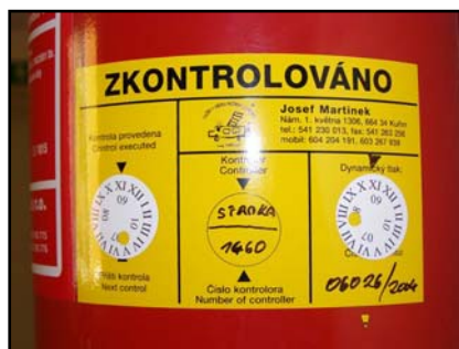
Abb.6: Informationen über die Kontrolle des Löschgerätes
